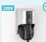
EV充電用AC200Vコンセント
